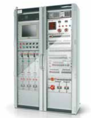
55 Шкафов для систем собственных нужд подстанций
